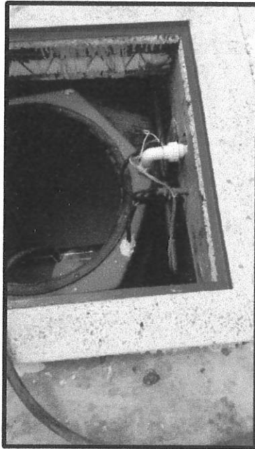
Fotografía 4 . Cisterna de litros.
